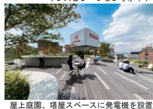
屋上庭園、塔屋スペースに発電機を設置
