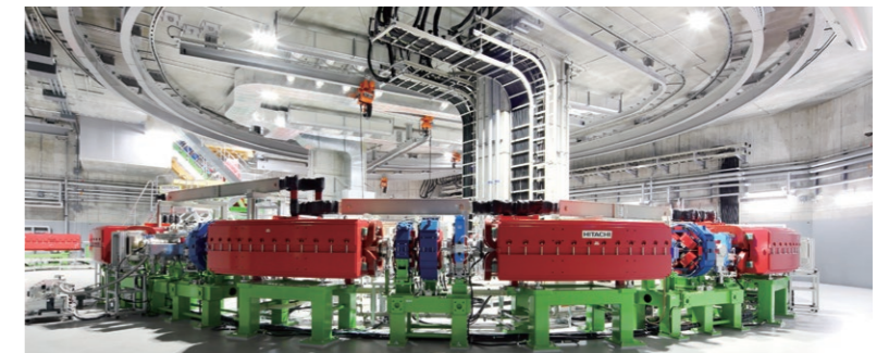
エアコンを装置周囲に分散配置した加速器室
