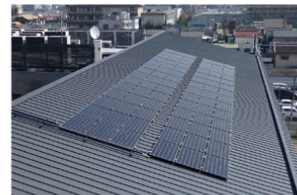
太陽光発電設備のシステム (20Kw)
