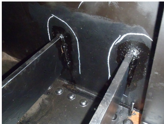
リブ溶接部 塗膜劣化
