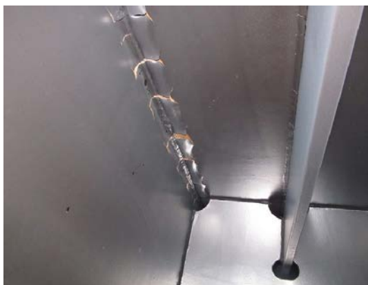
鋼桁内部の溶接部塗膜われ
