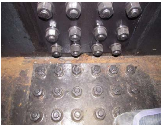
添接部付近の腐食
