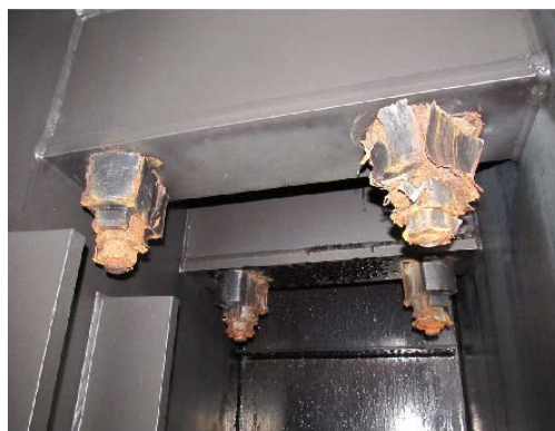
軌道桁支承アンカーボルトの腐食（箱桁内）
