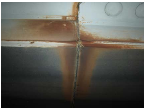
(c) 軌道桁連結板部の腐食
