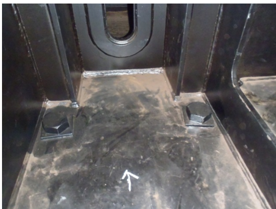
滞水による腐食
