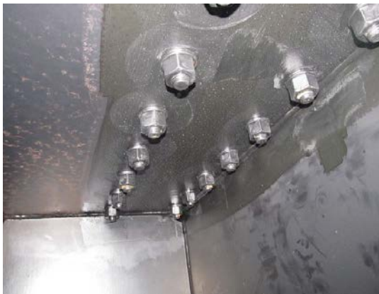
内面上部からの結露
