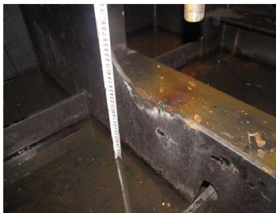
鋼部材の腐食
