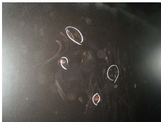
Webの塗装劣化
