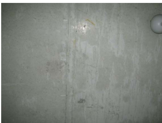
床板ひびわれ
