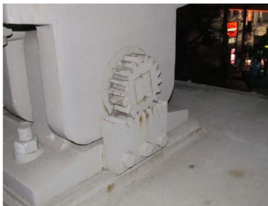
ギア接触部の塗装劣化
