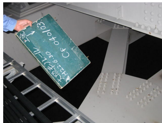
(b) ガセットのボルト頭部の軽微な腐食
