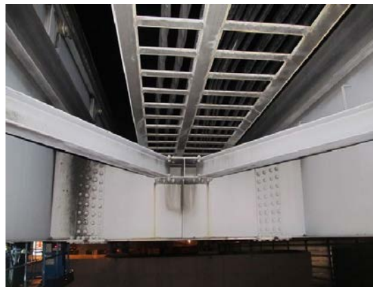
横桁・横構のすす汚れ
