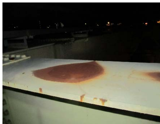
横桁上フランジの腐食
