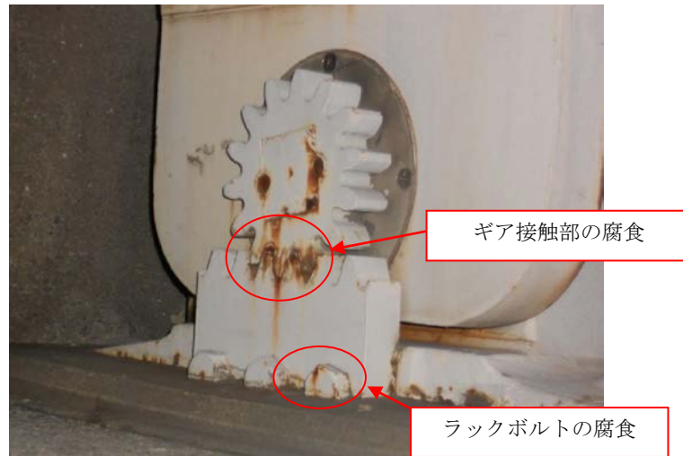
図 5.5 鋼軌道桁可動支承の腐食の一例
