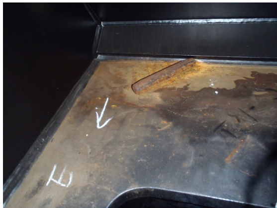
滞水、鋼材からの錆
