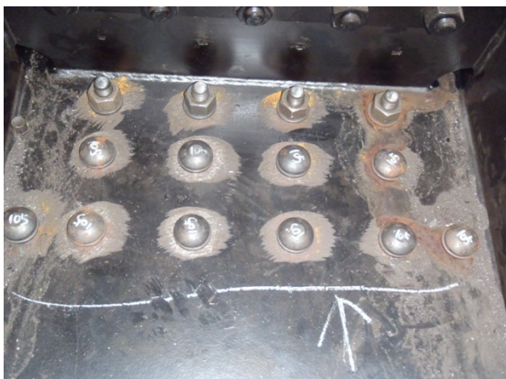
添接部の滞水による腐食
