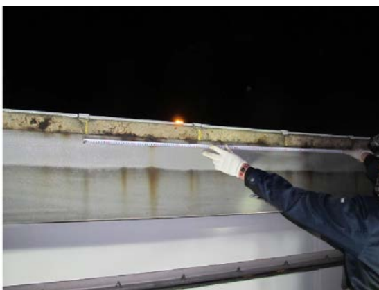
樹脂モルタルの損傷
