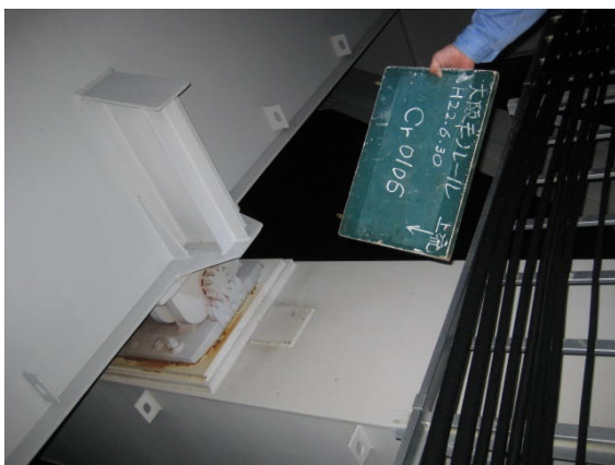
(a) 軌道桁支承部の軽微な腐食
