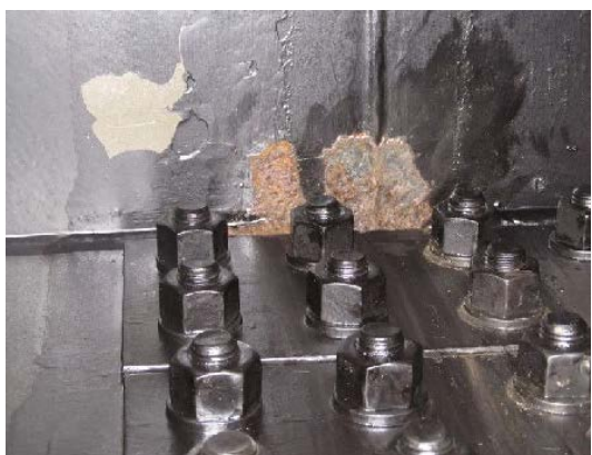
箱桁内部添接部の腐食（主桁側面）
