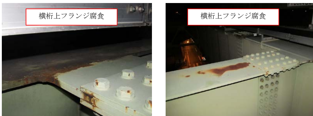
図 6.3.3 桁上部の腐食状況
