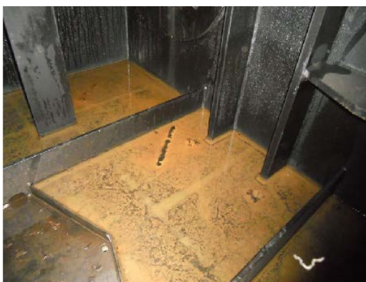
箱桁内部の滞水
