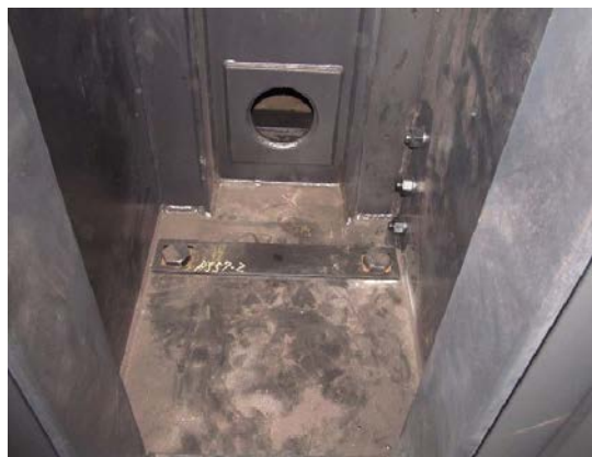
鋼桁内部の滞水跡（支承セットボルト付近）
