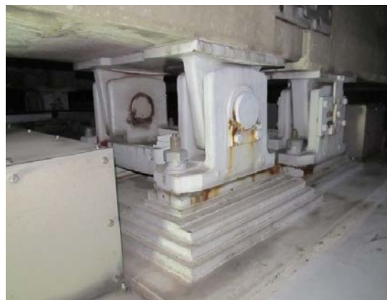
支承の腐食 (固定支承)
