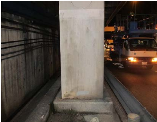
外面の塗装劣化
