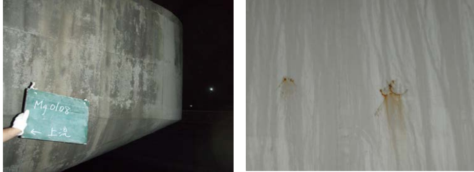
図 4.2 RC 橋脚の損傷例
