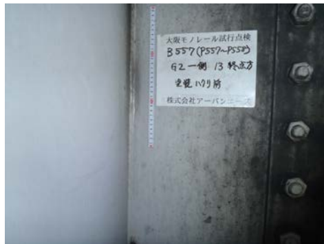
①塗膜割れ箇所(磁粉探傷試験実施前)
