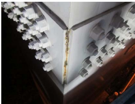
添接部の局所的な腐食
