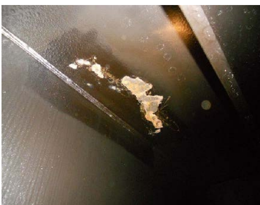
箱桁内部上部の塗装劣化
