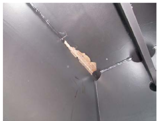
鋼桁内部の溶接部塗膜われ
