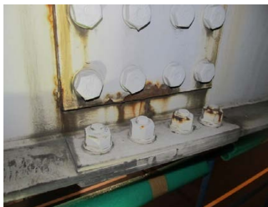
主桁添接部の腐食
