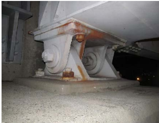
固定支承の局部的腐食
