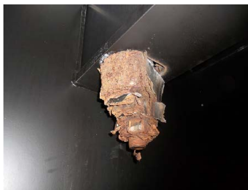
軌道桁支承アンカーボルトの腐食
