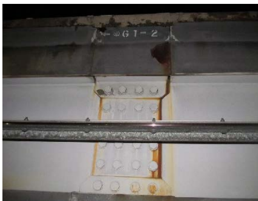
添接部の腐食（主桁側面）
