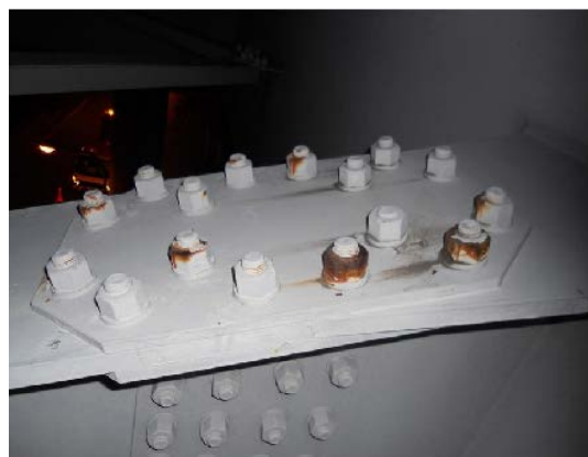
添接部の腐食（横桁上面）
