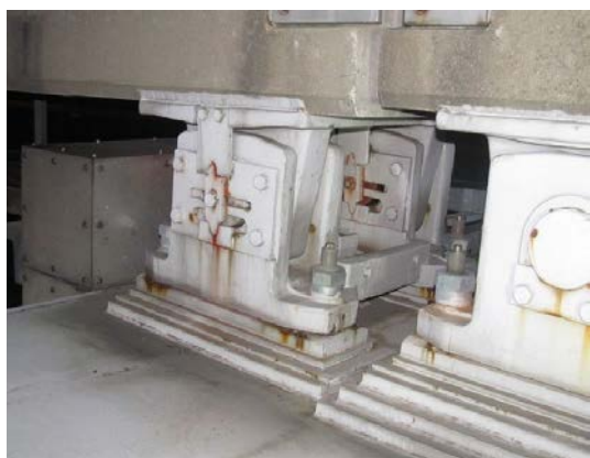
支承の腐食 (可動支承)
