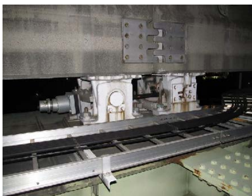
軌道桁支承の局所的な腐食
