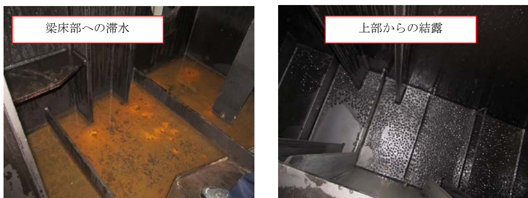
図 6.3.4 箱桁内部の滞水状況
