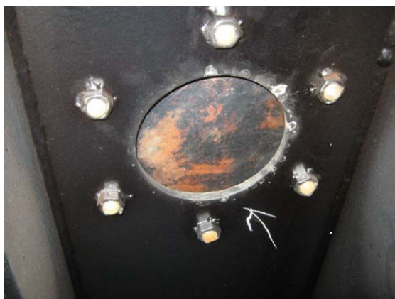
マンホールとボルトの塗装劣化
