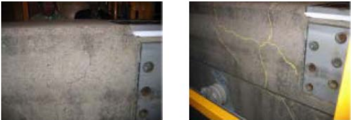
図 2.1 PC 軌道桁のひびわれ状況
