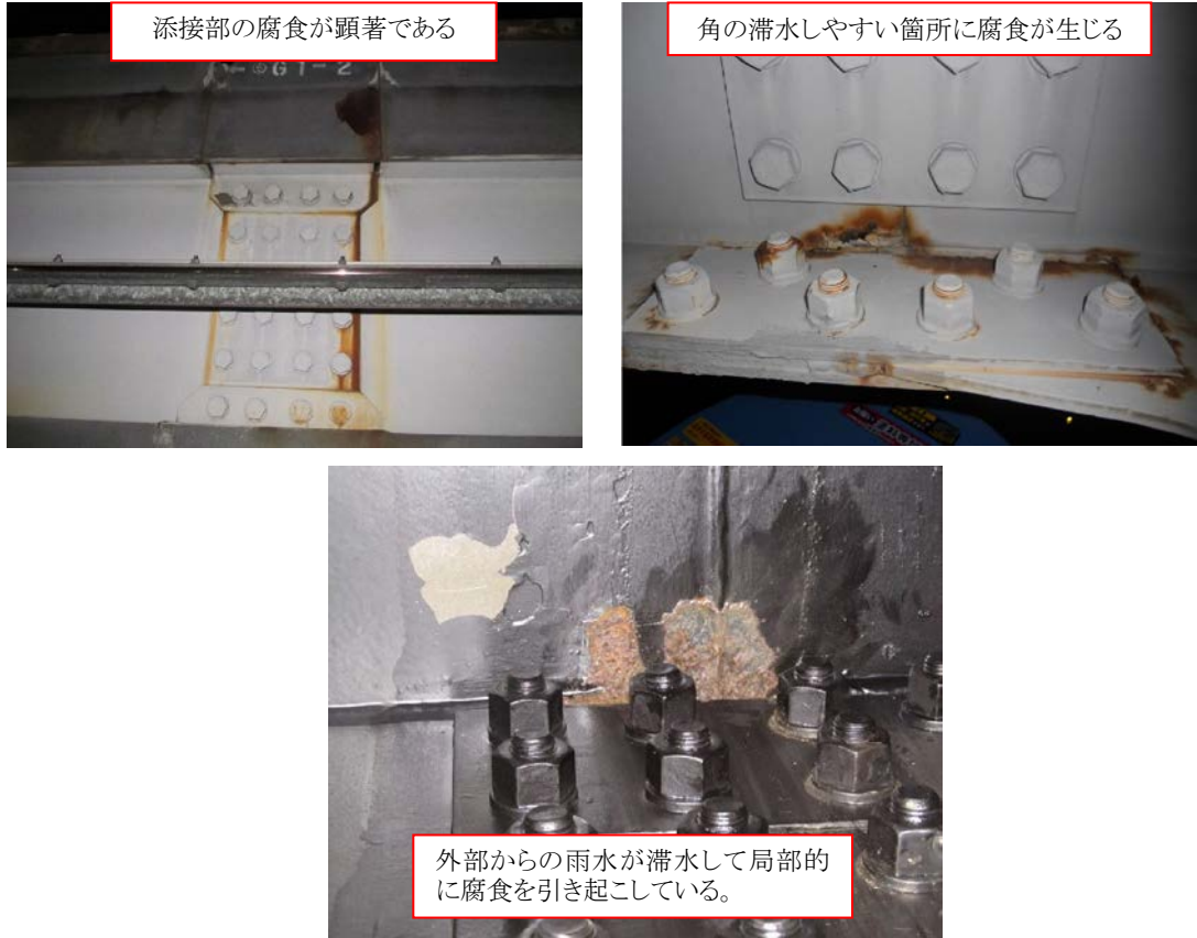
図 1.4 添接部の腐食状況
