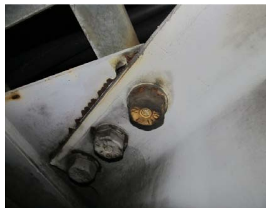
ボルトの腐食
