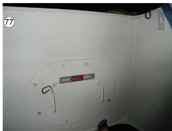
(b) マンホールボルト頭部の軽微な腐食
