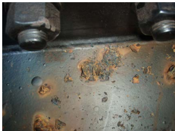
(b) 軌道桁内部塗装の軽微な腐食
