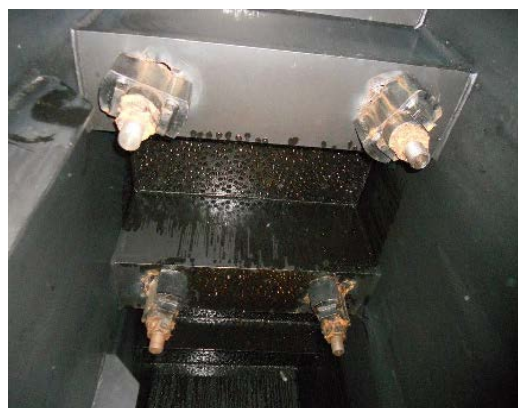
箱桁内部上部からの結露
