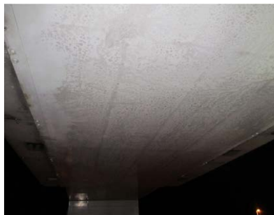
外面塗装の劣化
