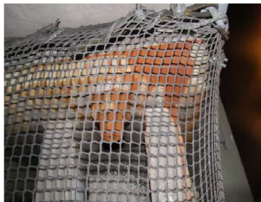
桁内部からの錆汁の漏水付着
