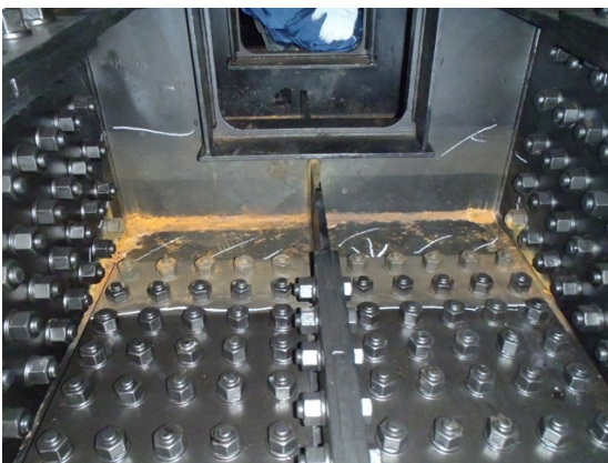
滞水による腐食全体状況
