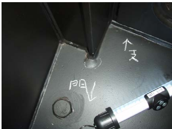
(a) 軌道桁内部塗装の膨らみ
