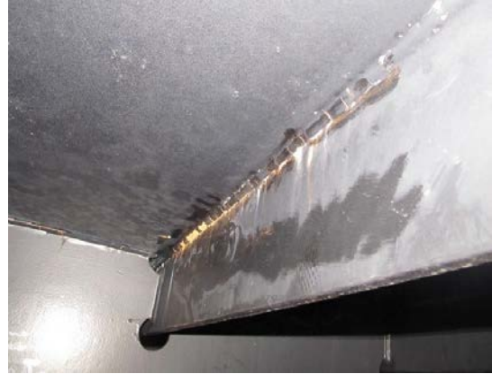
内面の溶接部付の腐食
