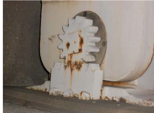
可動支承の局部的腐食
