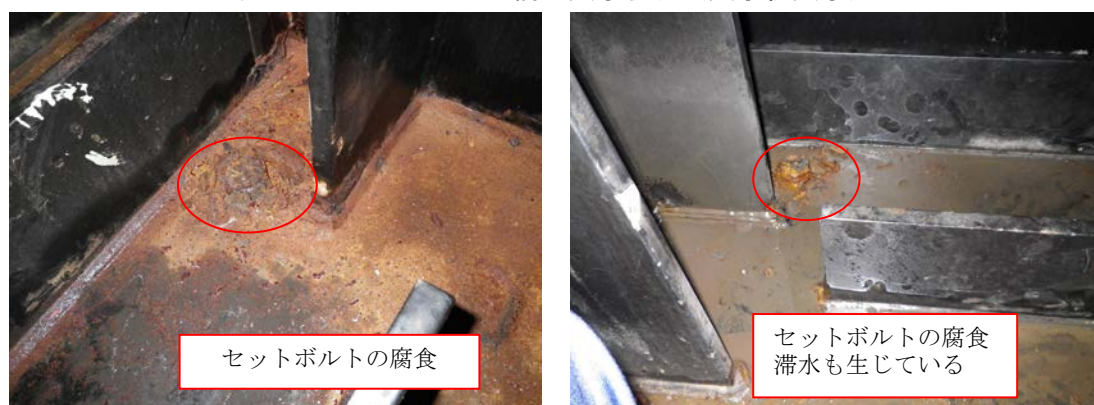
図 6.3.2 箱桁内部セットボルトの腐食状況
