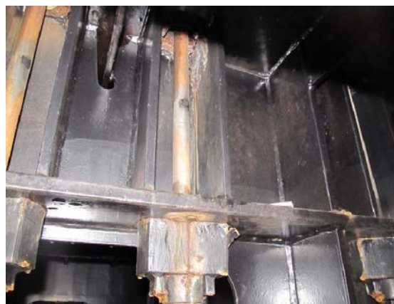
鋼部材の腐食（支承）
