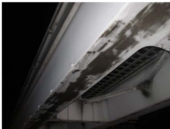
主桁下面のすす汚れ
