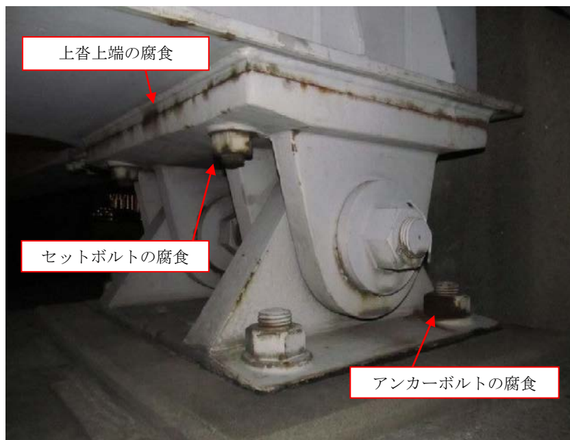
図 5.3 支承の腐食状況の一例
