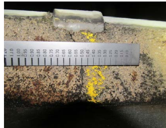
樹脂モルタルの損傷(w=0.5mm)
