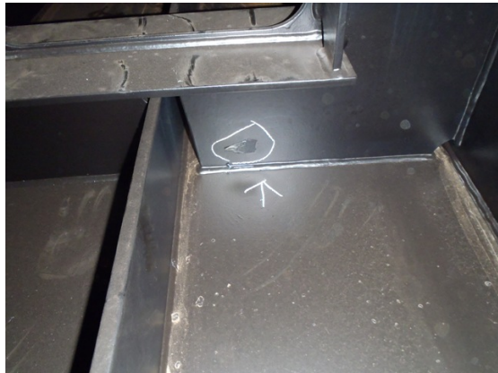
塗膜の剥がれ
