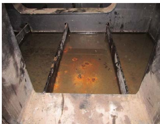
支柱内部の滞水状況
