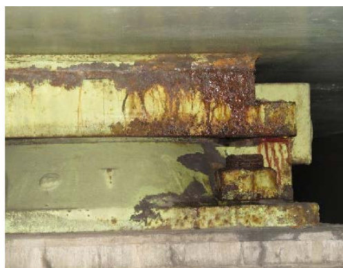
モノレール橋支承の局所的な腐食
