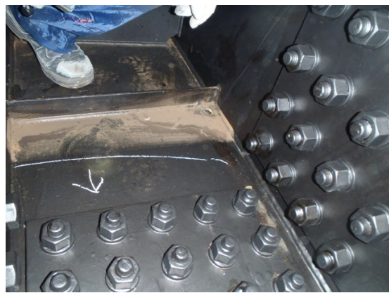
滞水による腐食
