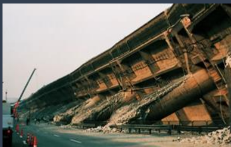
倒壊した阪神高速道路
