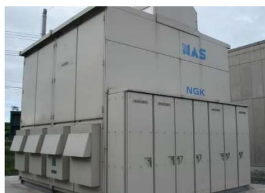
大型蓄電システム施設
