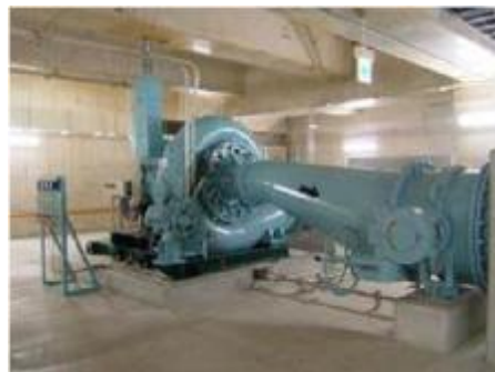
長居水力発電設備
