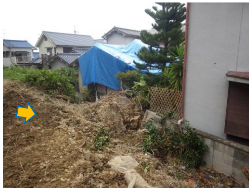
H30年7月豪雨 かけ崩れ（阪南市）
