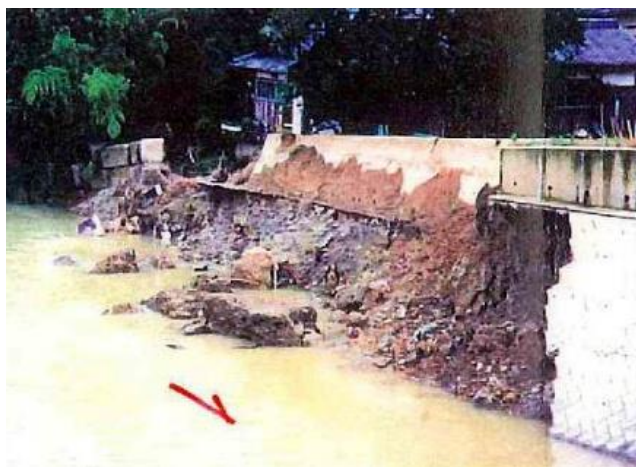
平成7年7月2日～5日 樫井川 母山橋上流左岸
