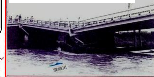
千歳橋の橋脚破損(茨木市戸伏町)
