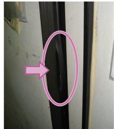
【パッキンの劣化】
