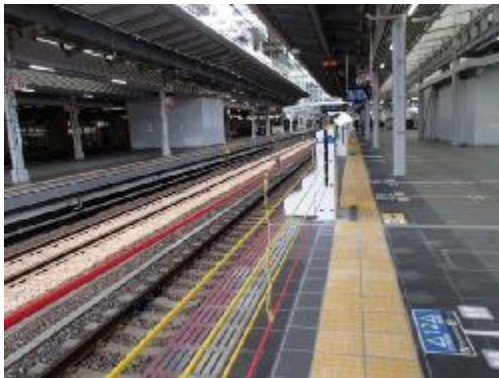
西日本旅客鉄道(株) 東海道本線 大阪駅 (昇降式ホーム柵)
