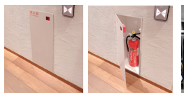
廊下上の壁埋込型消火器ボックス
