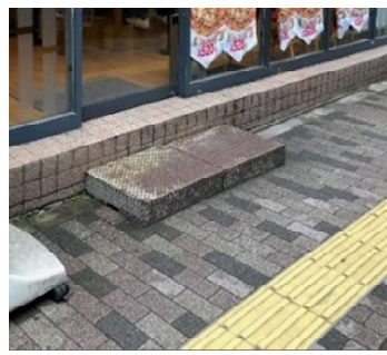
●踏み段を道路内に設置 段差のため、車椅子使用者が入店困難であるうえ、踏み段が、歩道上に設置されており、通行の障害となる。
