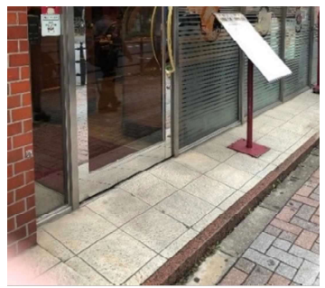
●段差かつ外開き戸のため、車椅子使用者の入店が困難。
