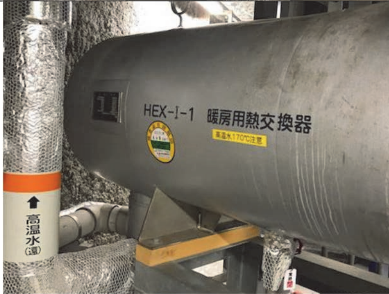
写真 2 地域冷暖房供給 暖房用 熱交換器
