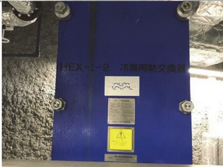
写真 3 地域冷暖房供給 冷房用 熱交換器
