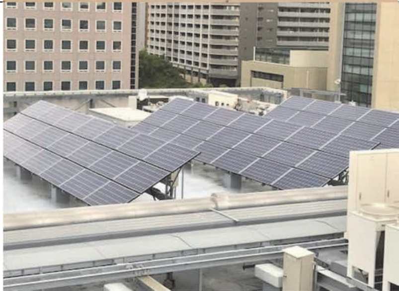
写真 9 太陽光発電パネル (非常動力系統で使用)
