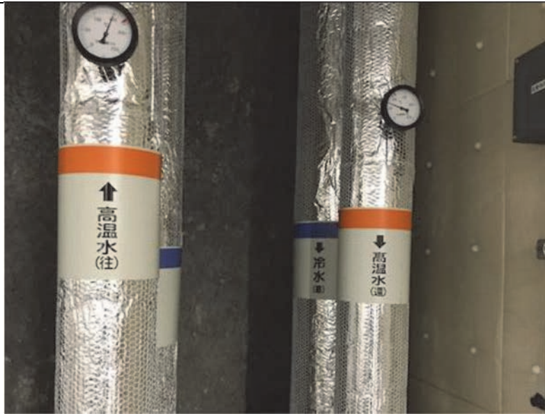
写真 1 地域冷暖房供給配管 (館内の冷暖房に使用)
