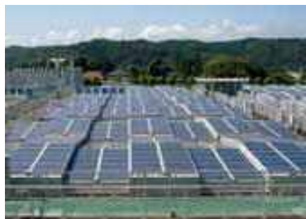
＜浄水場の太陽光発電＞
