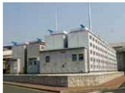
<電力貯蔵型蓄電池(NaS電池)>
