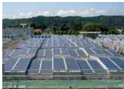
＜浄水場の太陽光発電＞
