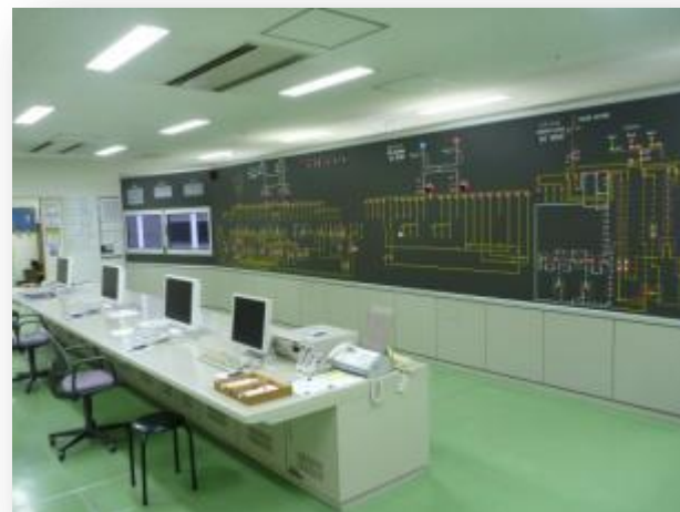
コミュニティ全体の電力監視
