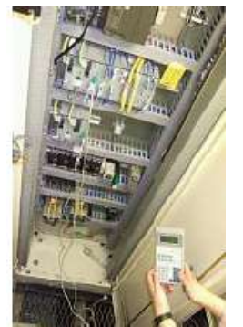
空調機ファンインバータ調整
