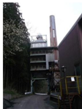
<釜石市の仮設焼却炉>
