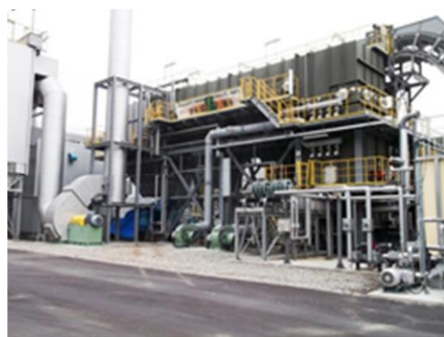
<宮古市の仮設焼却炉>
