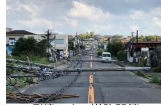
倒壊による道路閉鎖
