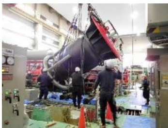
写真 6 機械設備の改築更新の例(ポンプ)
