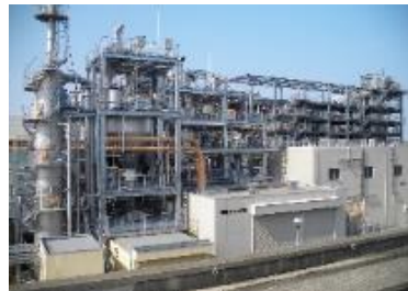
写真 19 省エネ機器の例 (過給式焼却炉)
