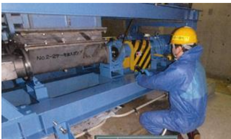
写真9 設備の点検状況
