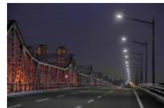
LED道路照明
