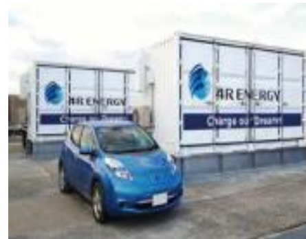
○EVリユース蓄電池
