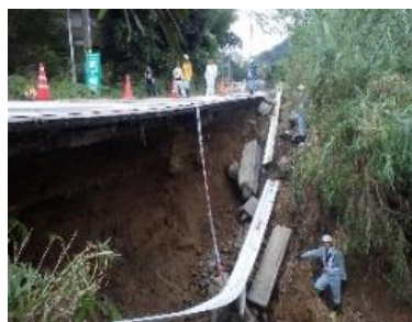
道路法面の崩落 (2018年7月)
