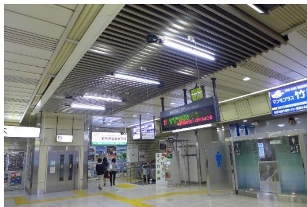
JR 前橋駅コンコースに設置された天井冷房システム
