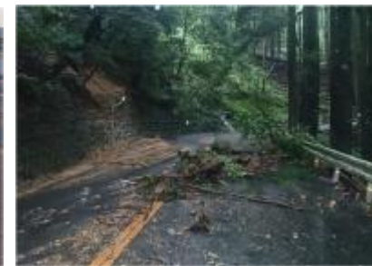
(例) 法面崩落、倒木
